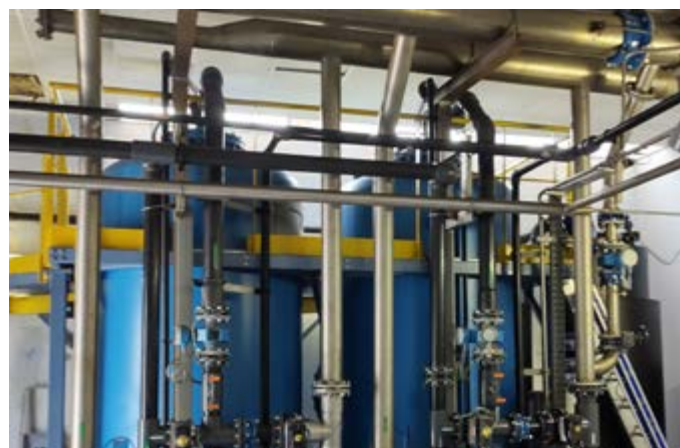
Unité de traitement de l'eau.
